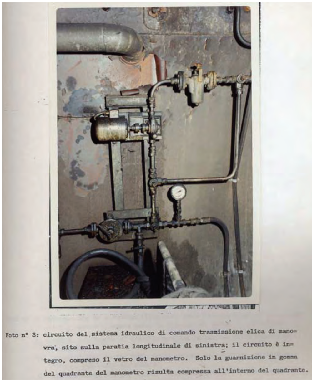
Figura 23. Tubazioni con il vetro del manometro intatto nel locale elica di manovra.
